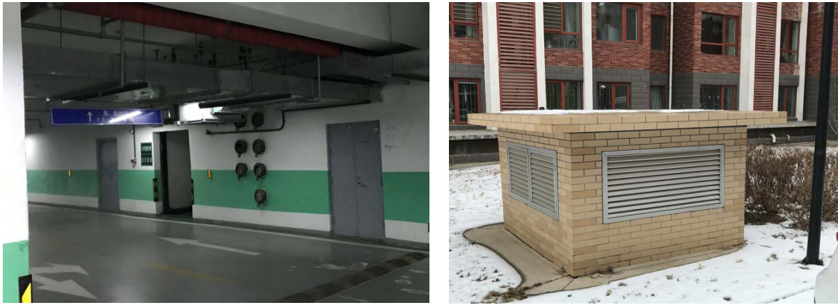
图 4.1-4 本项目地下车库风系统及百叶窗排气口情况
